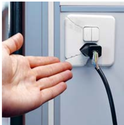
Bild 2: Beschädigte Abdeckplatte und defektes Kabel. Es besteht Elektrisierungs-Gefahr.
