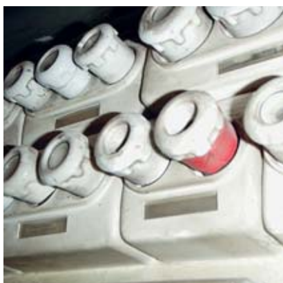
Fig. 1: corps céramique défectueux. Risque d'électrisation.
