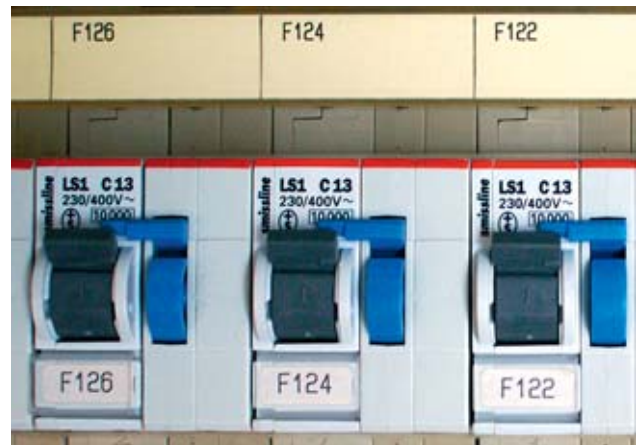
Fig. 11: disjoncteur de ligne
