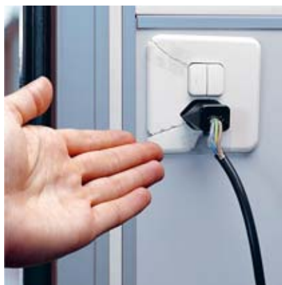
Fig. 2: enveloppe isolante endommagée et câble défectueux. Il existe un risque d'électrisation.
