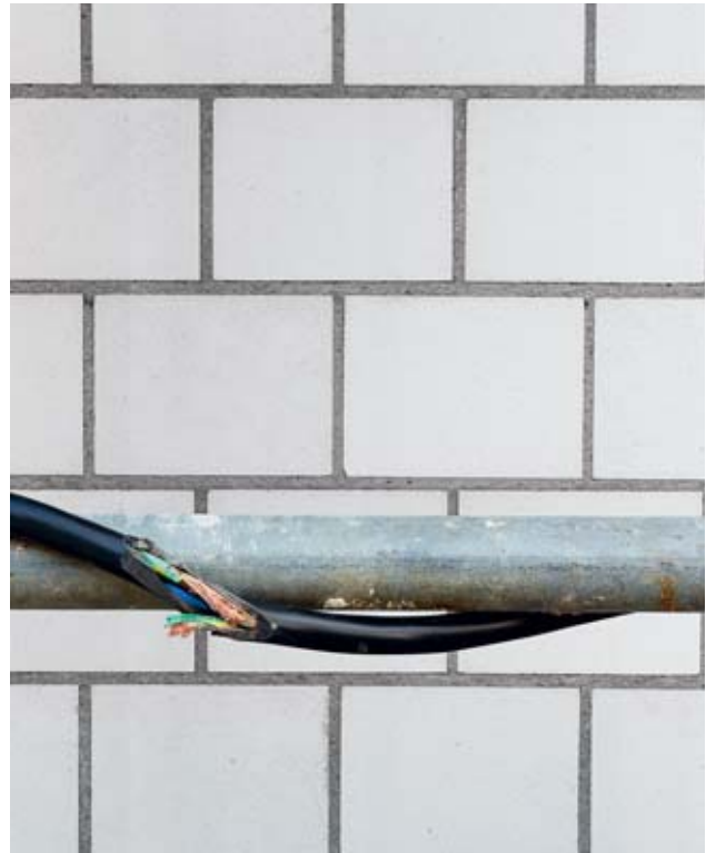
Fig. 16: rien ne sert d'utiliser des câbles et appareils défectueux!
