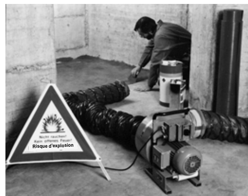
Fig. 5: une aération artificielle est nécessaire dans les caves. Le cas échéant, des ventilateurs mobiles seront utilisés.
