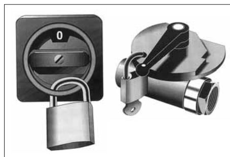
Fig. 12: lors de la maintenance, il faut neutraliser les énergies: déclenchement + cadenas personnel = SECURITE .
