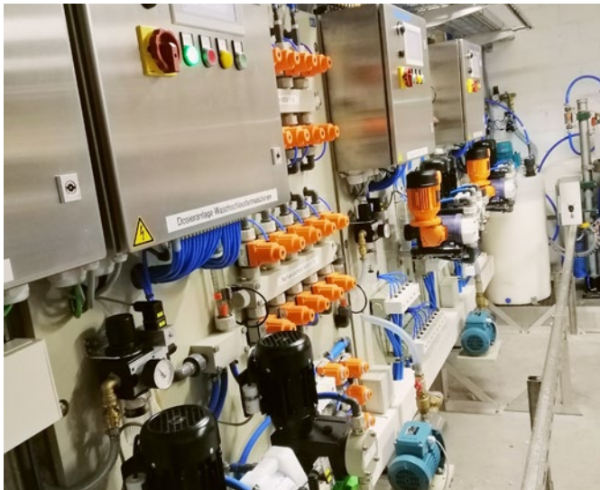
Die Dosieranlagen sind in einer kompakten Bauweise ausgeführt.
