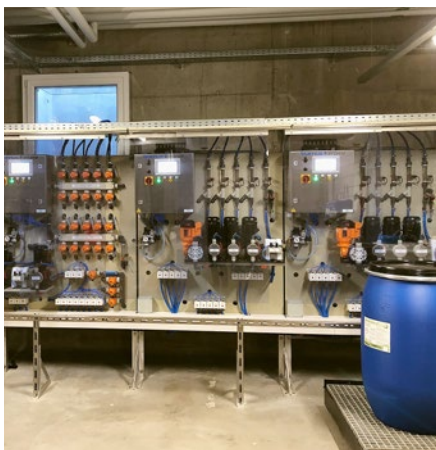
Die GREEN Line-Produkte werden über vier Compact Line-Anlagen dosiert.
