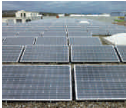
Auf dem Dach der Wäscherei Regio AG wurde 2011 eine Photovoltaikanlage installiert, mit welcher jährlich 30'000 Kilowattstunden Strom produziert werden können.
